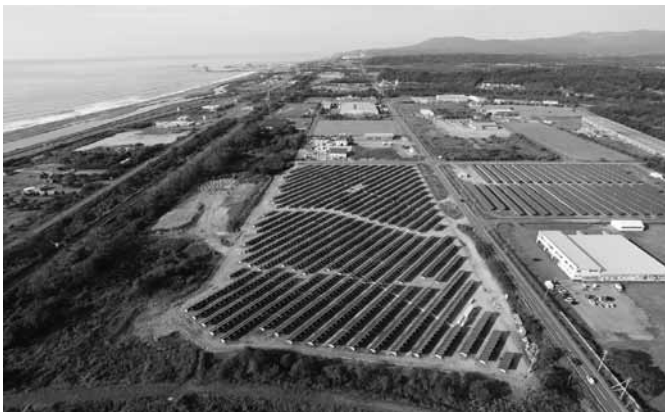
町内に設置された太陽光パネル（SBエナジー設置）
